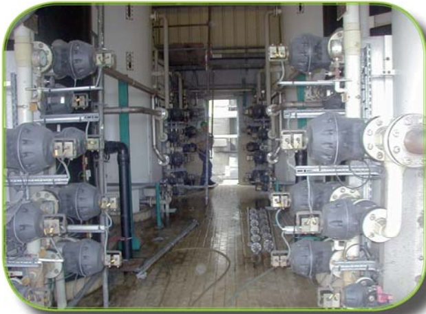
Duplex Déminéralisation Energie Electrique
